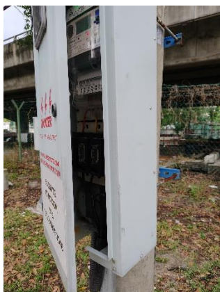
図 15 開いている配電盤 (危険)
